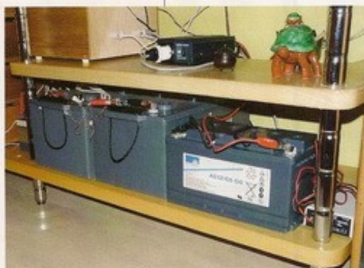
Les batteries Vue d'un des séries de batteries utilisées pour l'alimentation des amplificateurs Solid Rock. Sur le côté droit, une batterie au plomb gélifié de marque Sonnenschein, 12 V/65 Ah, version A 512 /65 G6.
